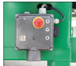
E-Motor Anschluss mit Schutzschalter
